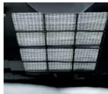
Внутренний воздушный фильтр циркуляционного контура
